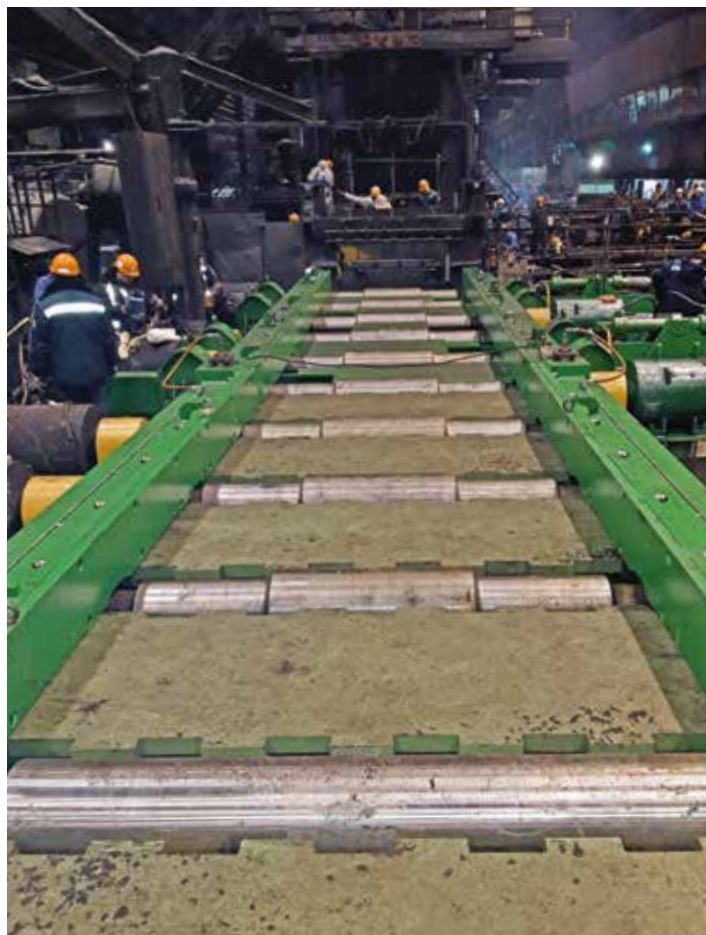
Umbausituation im Bereich der Schere. Installiert wurde eine neue hydraulische Führung von SMS group.
